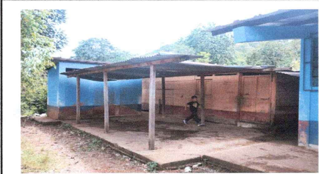
Foto 1: Estructura y cubiertas de laminas, Repacion de este techo por malas condiciones cuando llueve se filtra el agua y cambio de torta.
